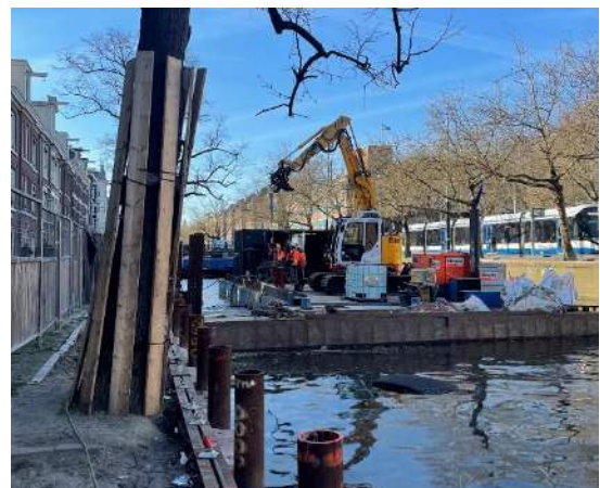
Figuur 1: Boom bovenop kademuur bij pilotproject Lijnbaansgracht.
